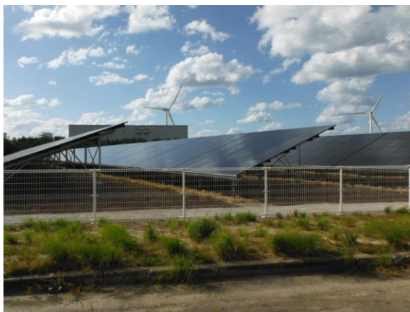
酒田港メガソーラー発電所
