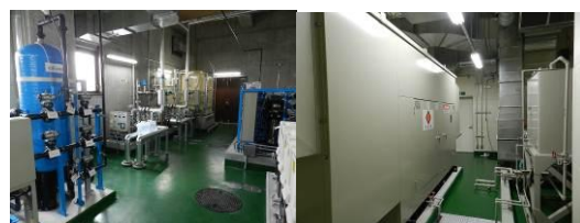
(海水淡水化装置、自家発電機)
